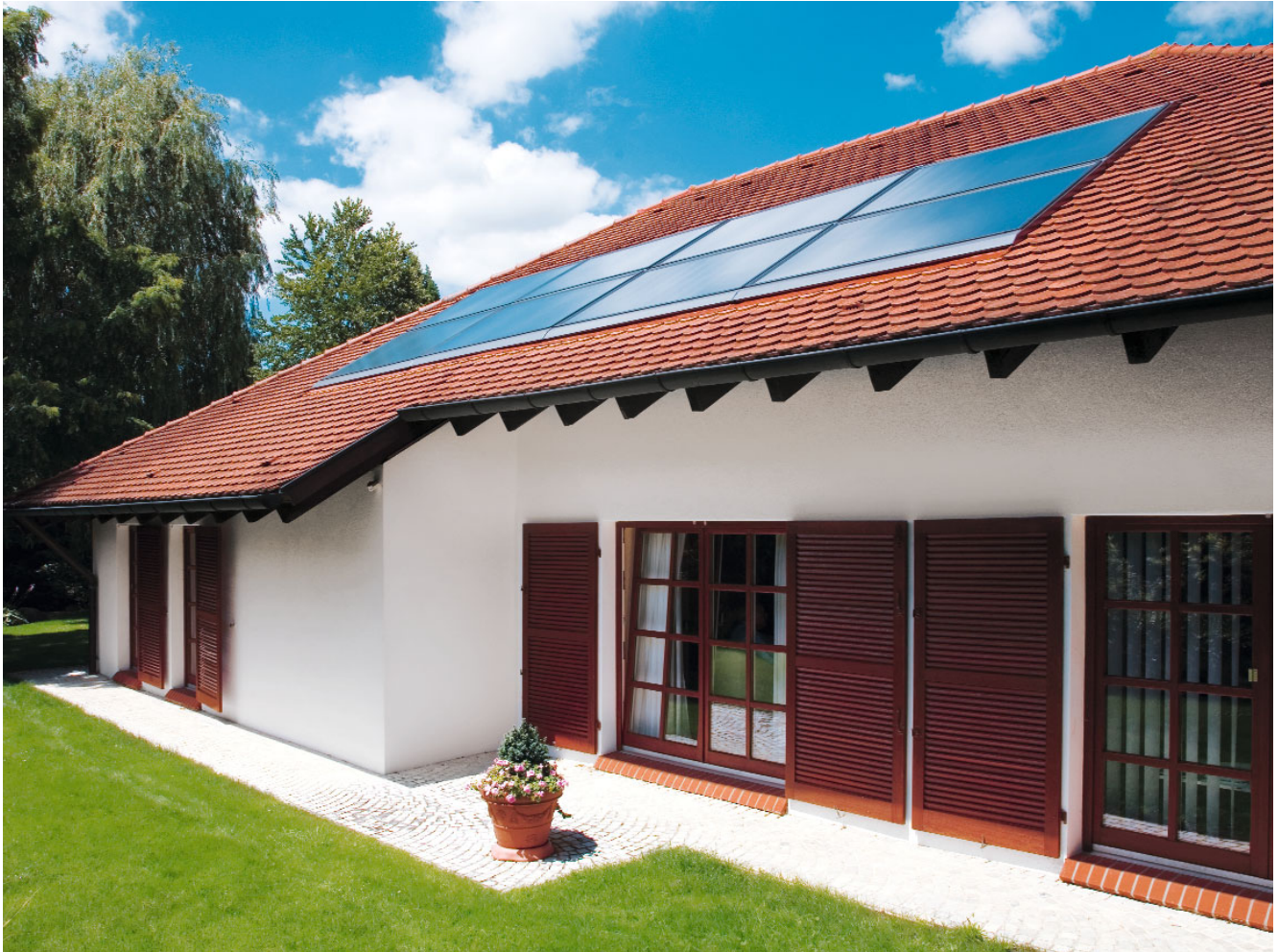
Installation solaire destinée à la préparation d'eau chaude sanitaire et à l'appoint chauffage
